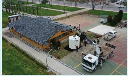
Ordu Doğa Kafe Çatı Yağmur Suyu Hasadı
